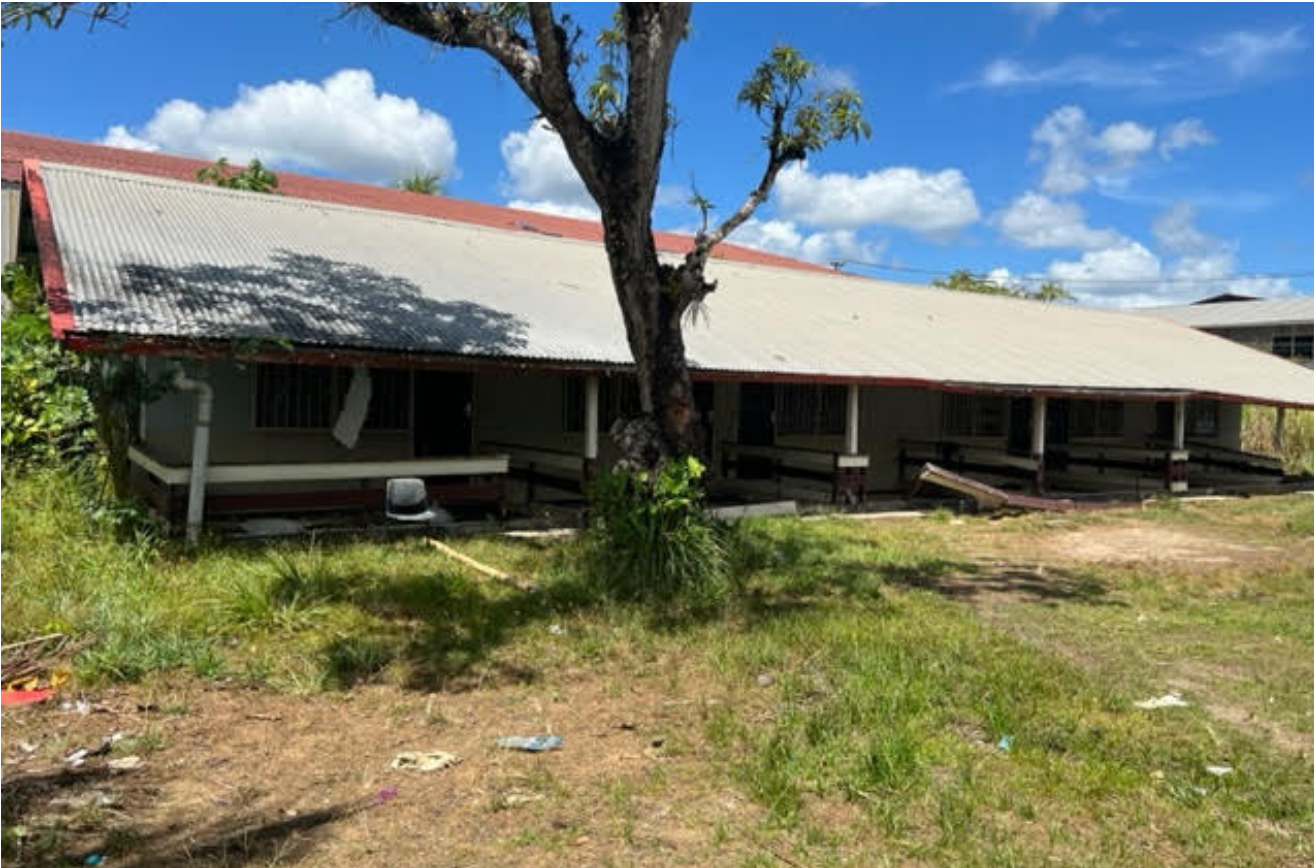
Onderwijzerswoningen die onder water lopen bij de eerste beste regenbui omdat het water niet meer afgevoerd kan worden. Schandelijke kapitaal vernietiging door wanbeleid van de overheid.
